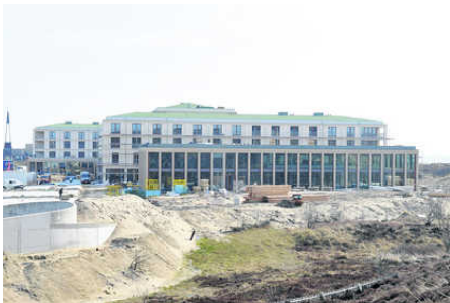
Noch bestimmen Bauarbeiten das Bild rund um das Fünf-Sterne-Haus an der Nordspitze Sylts (oben). In wenigen Tagen soll alles fertig sein, rechts die Ansicht von der Wattenmeerseite. Foto: FRENZEL
